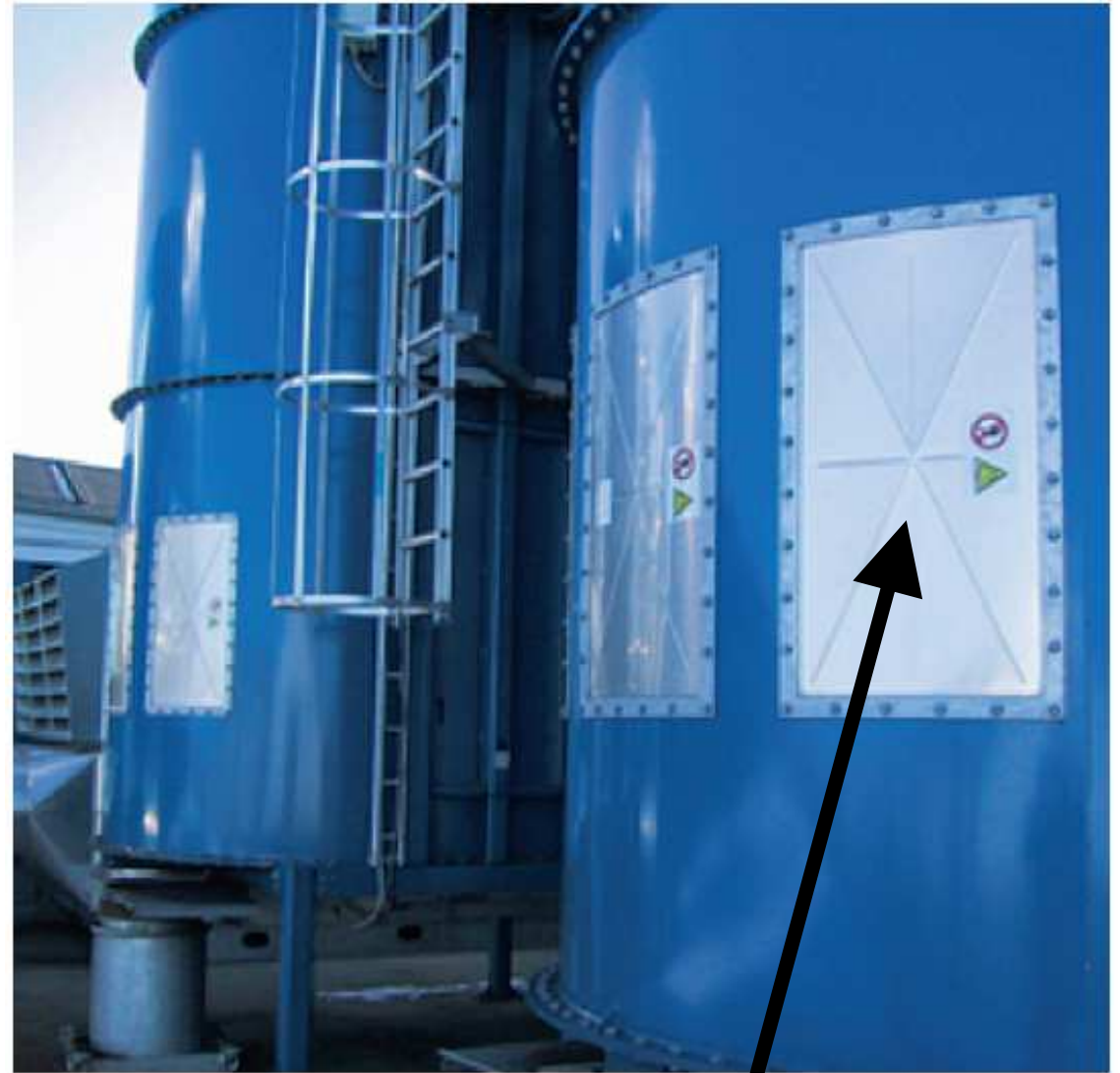
Pannelli di rottura
